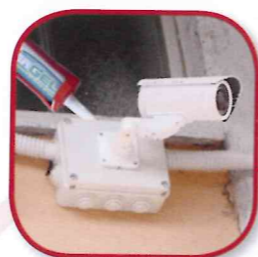
INSTALLATIONS DE VIDÉOSURVEILLANCE
